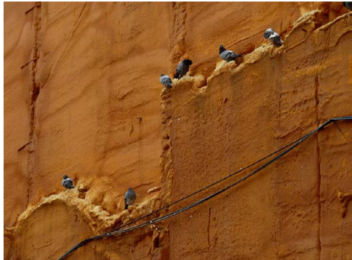
Abb 12 Provisorium? Fassade aus Polyurethanschaum, Barcelona.
